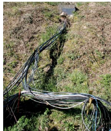
Mehrere Kilometer Kabel laufen in Schächten quer über das Gelände
