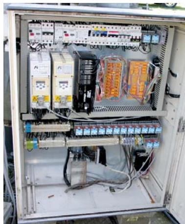
Jeder Spiegel wird von einem identisch aufgebauten Schaltkasten gesteuert
